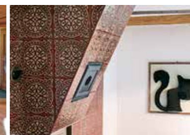
Der ehemals holzbeheizte Kachelofen im Wohnraum verfügt über einen modernen Ölbrenner. Auch heute noch beheizt er über das Rohrsystem auch den oberen Stock und vermittelt so authentische Kachelofen-Feelings.
